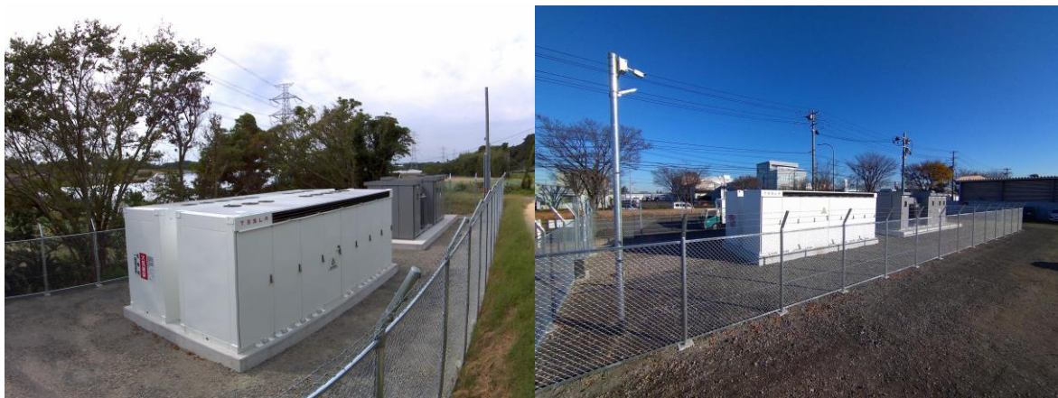
田原蓄電所（写真左） 仙台蓄電所（写真右）
